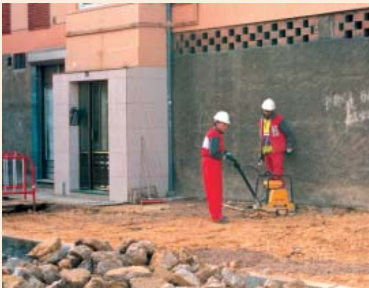
Operarios del Plan Piles III acondicionando una calle del barrio Nuevo Jove de La Calzada
